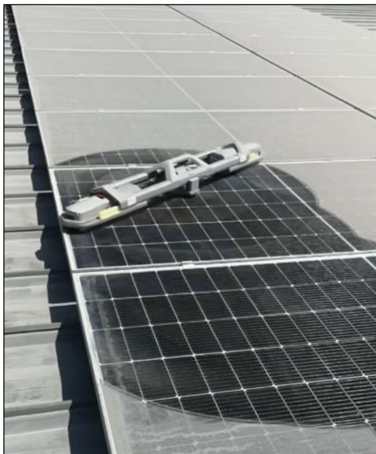
Sistemas fotovoltaicos em telhados de fábricas de Cimento
