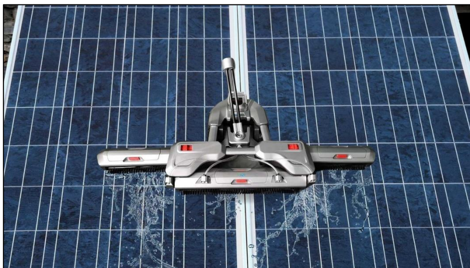
Robô de Limpeza de Módulos FV IFBOT M20
